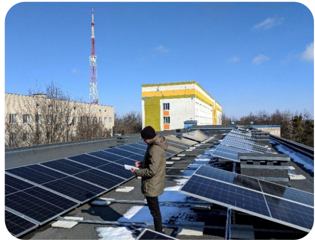
Xəstəxananın damında PV panellər
