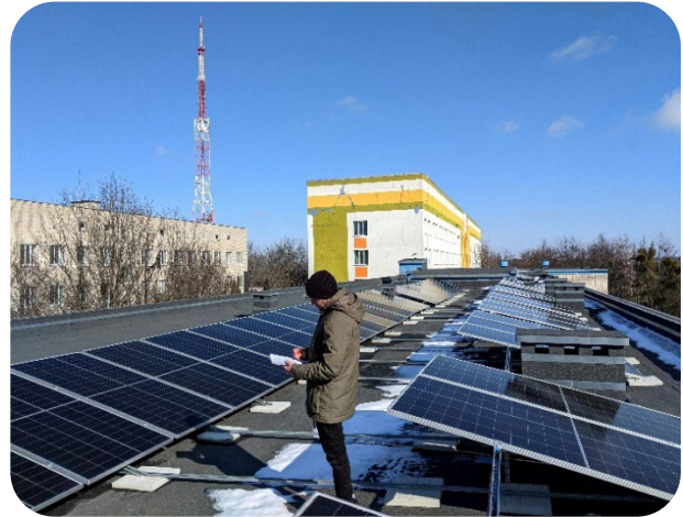
Panouri fotovoltaice pe acoperișul spitalului
