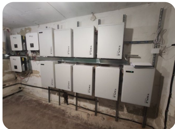
Батареї та контролери сонячної станції у підвалі
