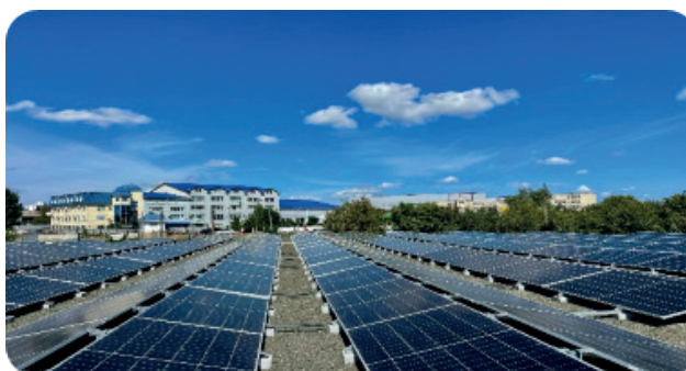
Panouri fotovoltaice la clădirile Luțkvodokanal
