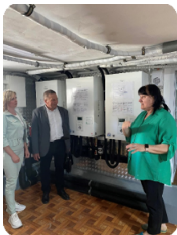
Контролери теплових насосів у підвалі
