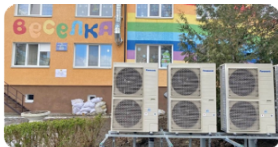
Теплові насоси на подвір'ї дитячого садка
